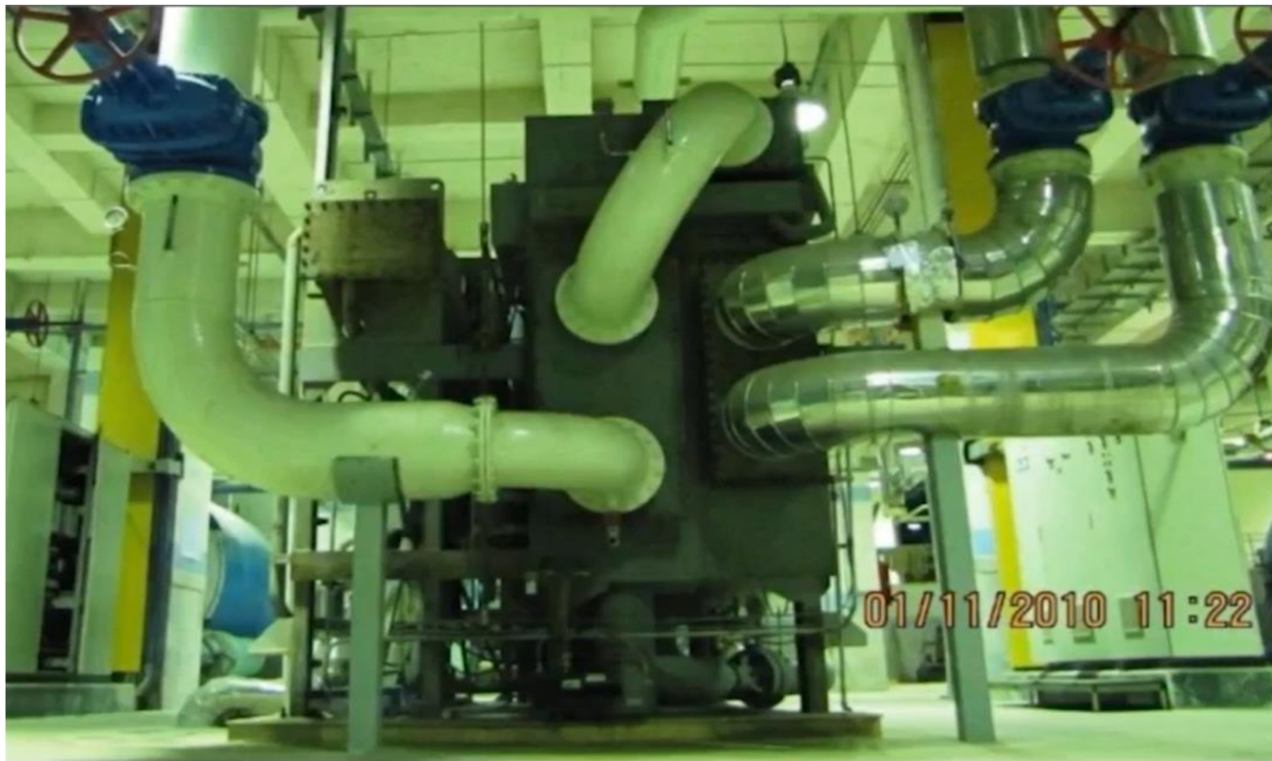
تجهیزات موتورخانه های مرکزی - چیلر ها جذبی دو اثره ۷۵۰ تن
